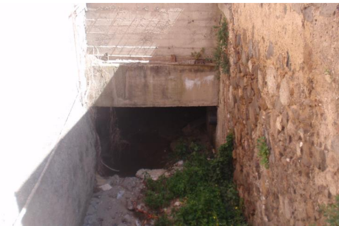
Figura 6: tombinamento al di sotto della ferrovia
