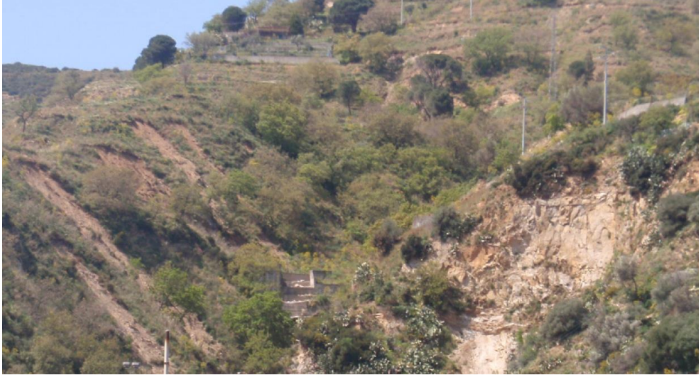
Figura 9: tratto 1 del torrente Farota con manufatto in c.a., nicchia di frana in sinistra orografica (destra foto) e dilavamenti in destra.
