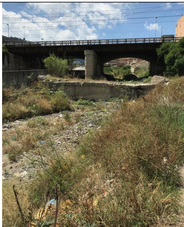
Figura 32 - vista del torrente Larderia, si notano una briglia e il ponte ferroviario
