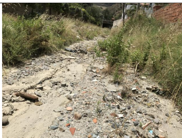
Figura 24 - vista del letto del torrente nella porzione intermedia, notare i frammenti di materiale misto da demolizione
