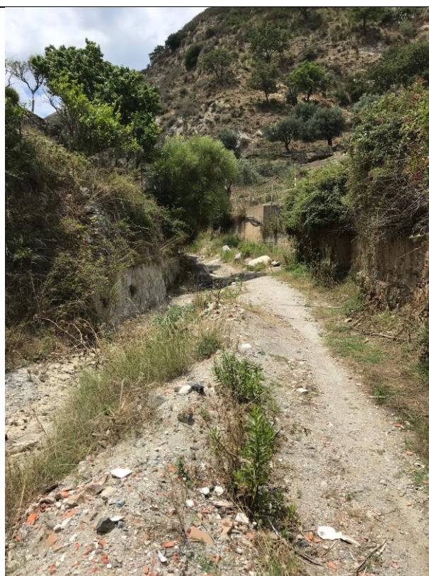
Figura 25 - vista del torrente, strada sulla destra e cumulo di rifiuti misti da demolizione abbandonati lungo l'argine
