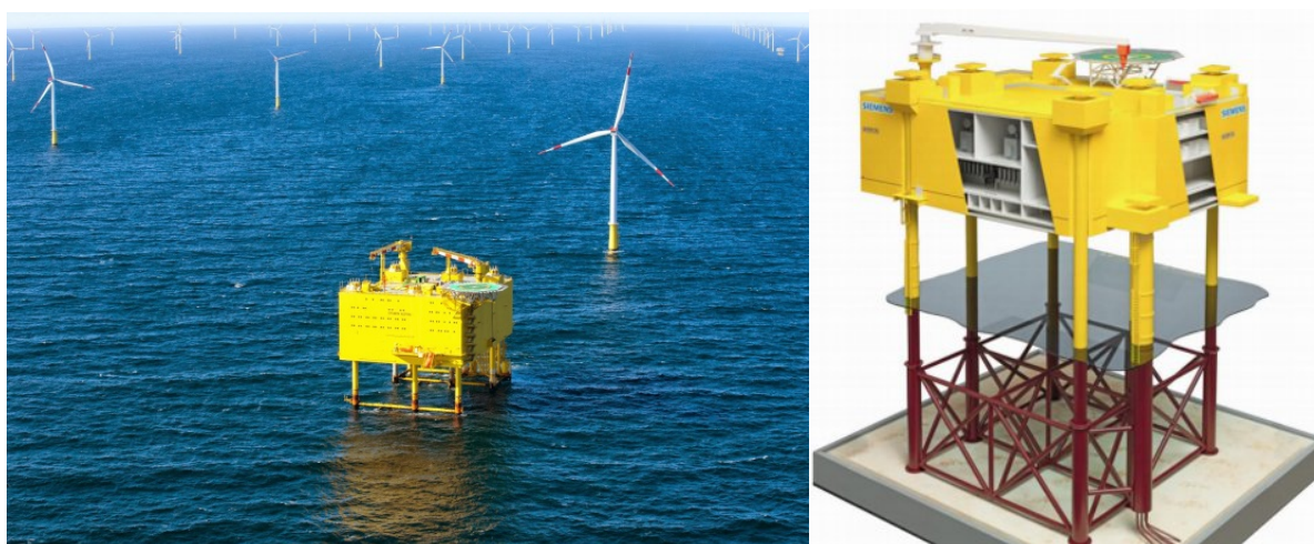
Fig. 11: Stazione HVDC di trasformazione e conversione 66/500 kV AC/DC.
