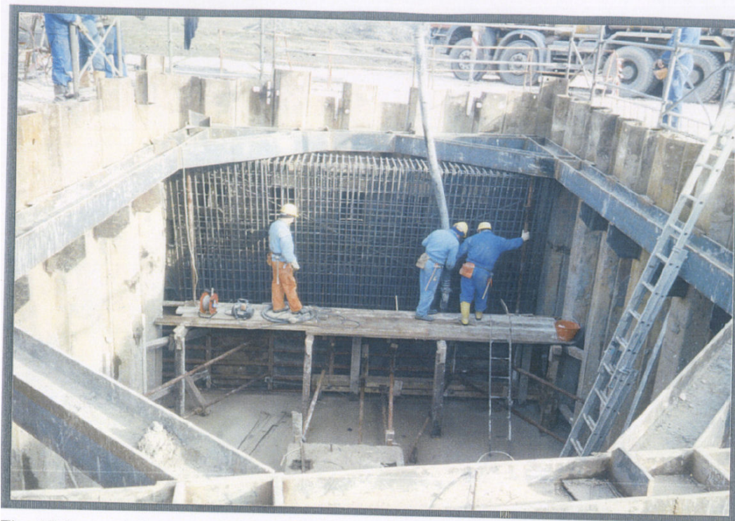
Fig.3: Attraversamento fiume Adige: realizzazione muro reggispinta nella postazione di spinta (tecnica del microtunnelling)
