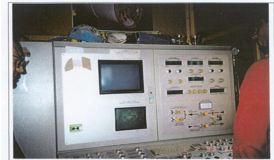
Fig.6: centralina di controllo remoto (tecnica del microtunneling)
