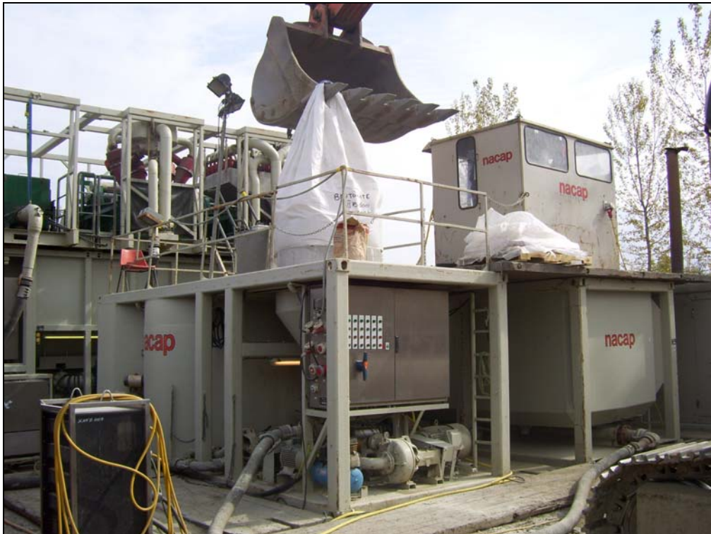
Attraversamento F. Po con met. 30” – Impianto di preparazione dei fanghi di perforazione
