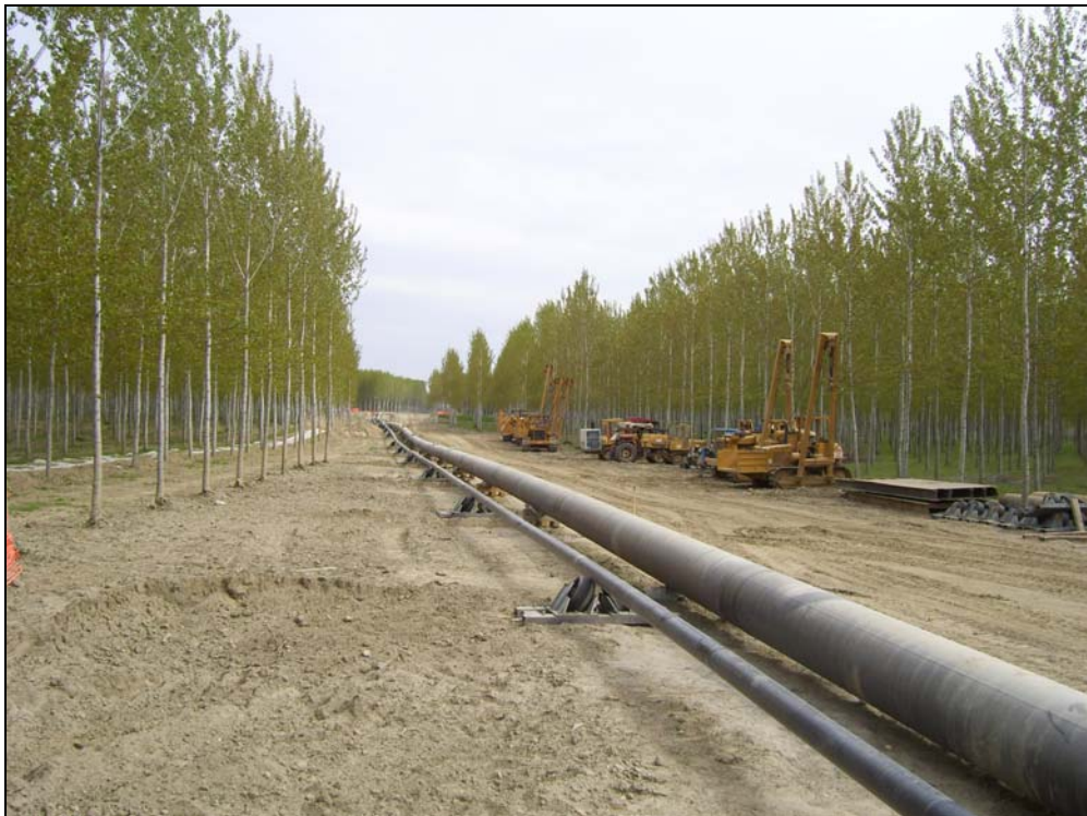
Attrav. F. Po con met. 30" – Colonna del pipeline preassemblata sulla pista di varo
