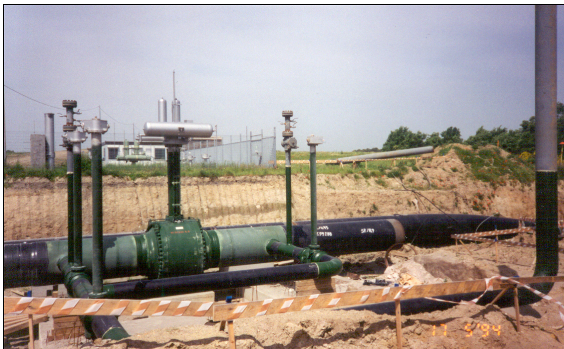
Foto 4.1/N: Punto di intercettazione di linea (PIL)
