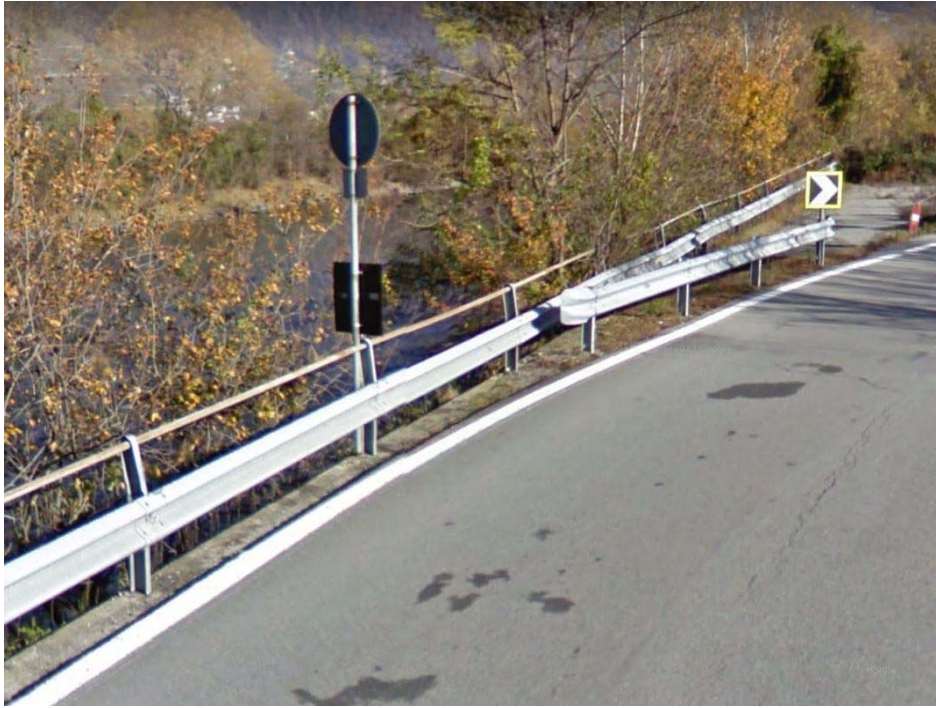
Barriera BP esistente in corrispondenza della ricucitura di via San Bernardo con via Adda (SP24)
