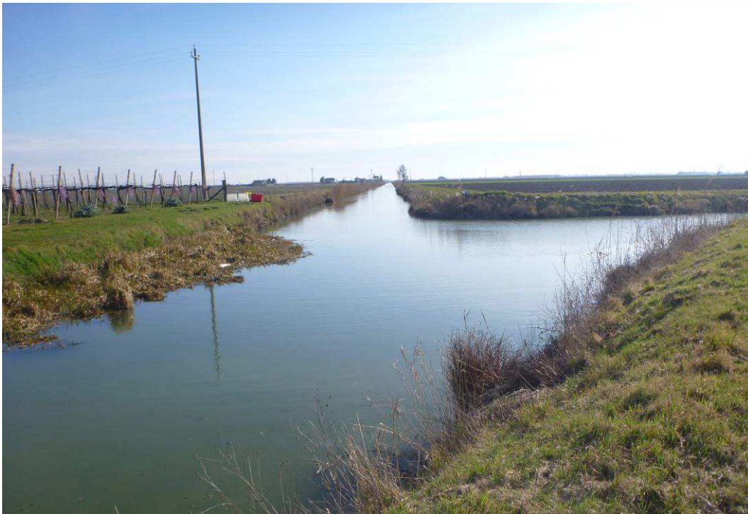
Figura 2.5 – FOTO 2: Principale Primo, vista nord-sud in corrispondenza della derivazione del canale Pesarona.
