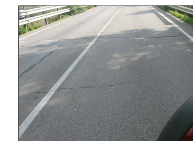
Crepe trasversali in corrispondenza del PG07
