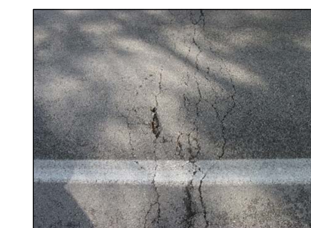
Particolare delle crepe in corrispondenza del PG7
