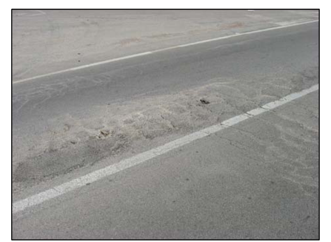
Fenomeni di ornaiamento nel tratto compreso tra PG 9 e PG 10
