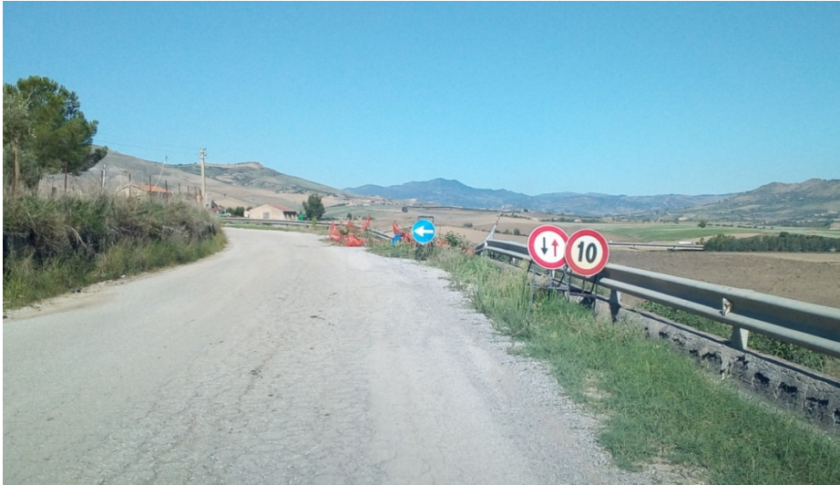
SP62 localmente dissestata e percorribile a senso unico alternato
