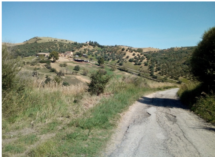
Condizioni della strada comunale 6 Sibbione-Rossi
