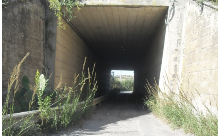
Sottopasso autostrada A19 che mette in collegamento le due aree di servizio Sacchitello
