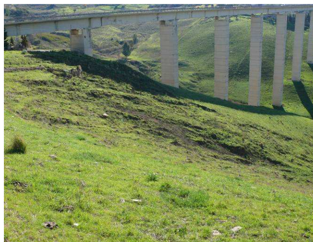
Fig. 7.4.10 – Dissesto gravitativo superficiale verificatosi nella zona immediatamente sovrastante l'imbocco della GN S. Filippo
