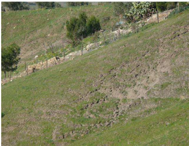
Fig. 12.3 – Dissesti gravitativi superficiali verificatisi nella zona immediatamente sovrastante l'imbocco della GN S. Filippo
