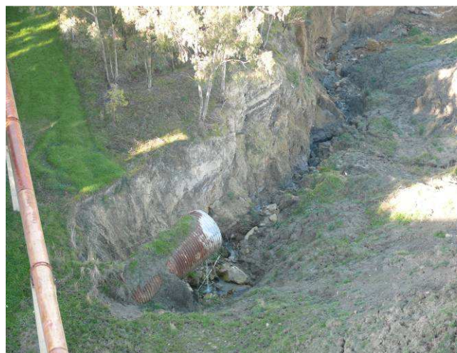
Fig. 7.4.7 – Lo sbocco della condotta tombata del canale di gronda sottostante il viadotto esistente, che induce evidente erosione laddove dovrà passare il VD S. Giuliano
