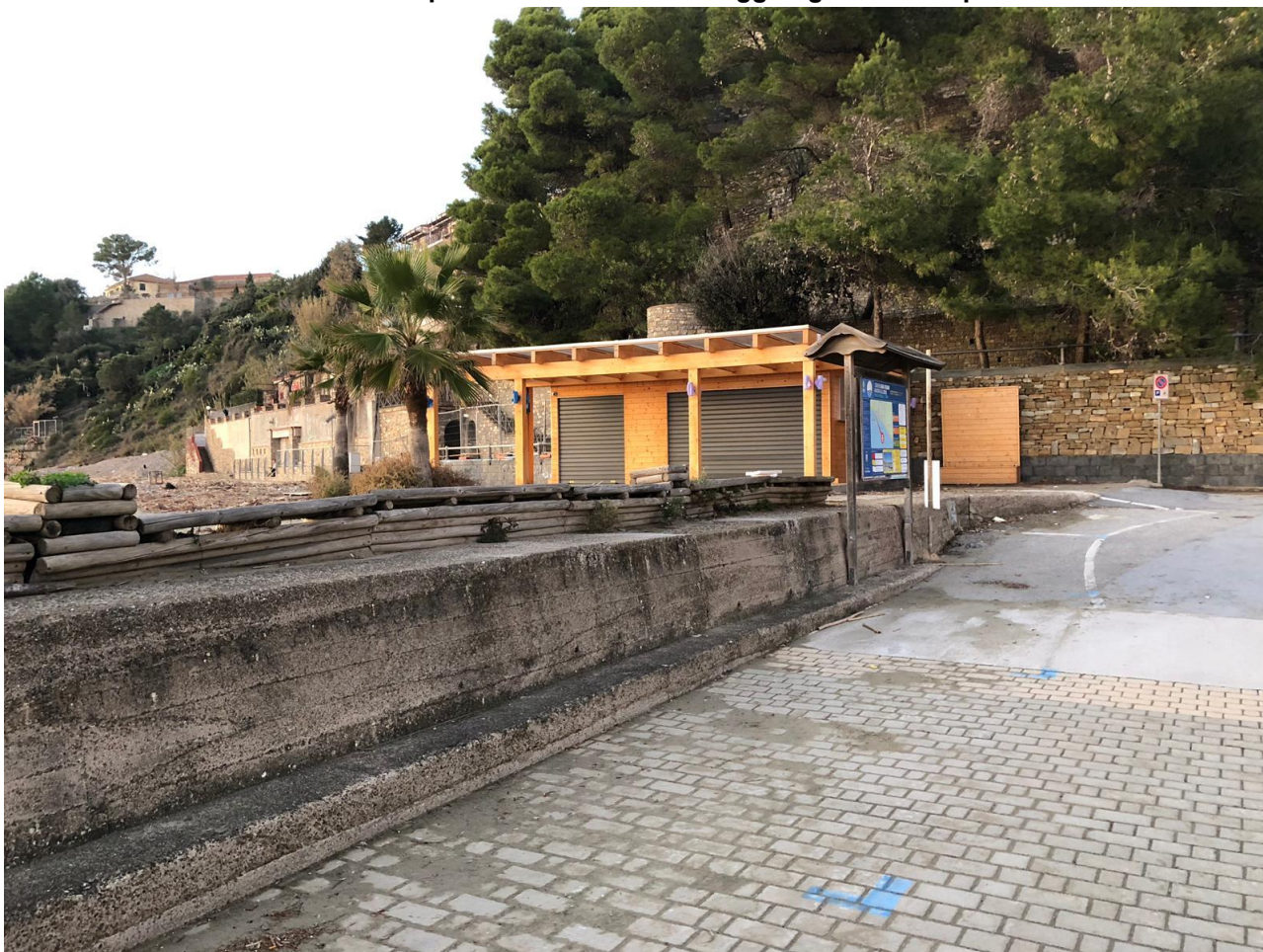
Figura 4 - Interferenza per accesso alla zona operativa 1 - Necessaria realizzazione rampa per scavalcare muro e permettere ai mezzi di raggiungere l'area operativa 1
