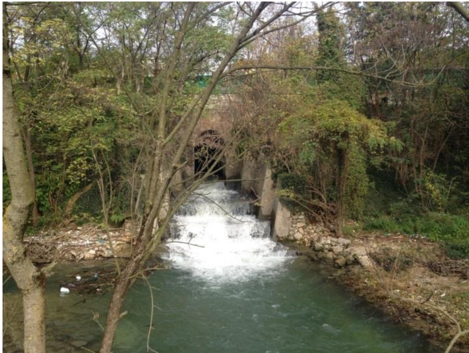
Progno Valpantena – Tratto tombinato e fine del tombino a valle della linea ferroviaria esistente
