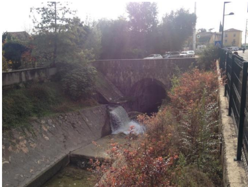
Progno di Valpantena – Tratto a cielo aperto a monte della linea ferroviaria esistente
