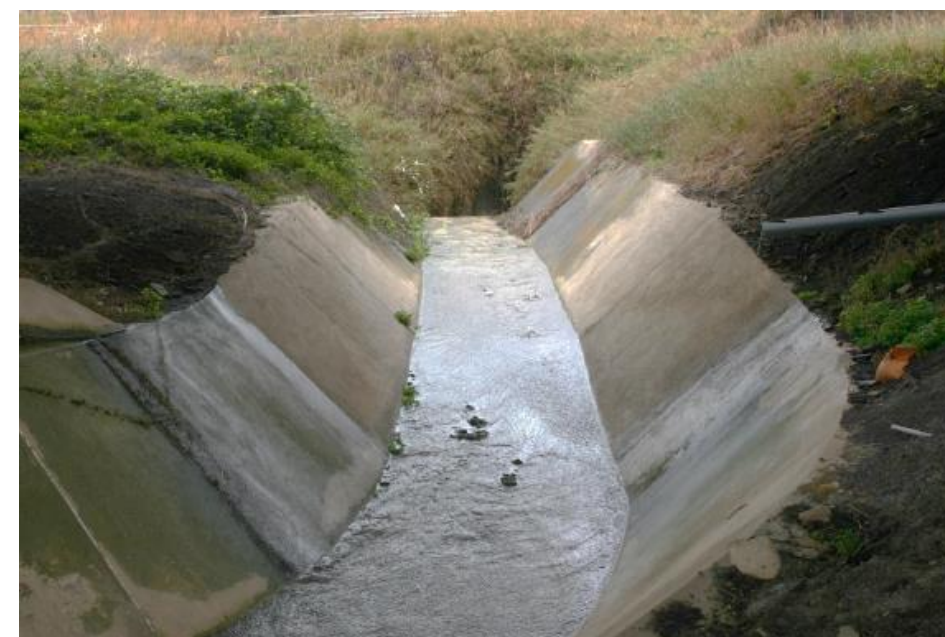
Figura 3-7. Fosso Cacchione e Caditoia del tombino idraulico di sottopasso della ferrovia (Vista verso valle)
