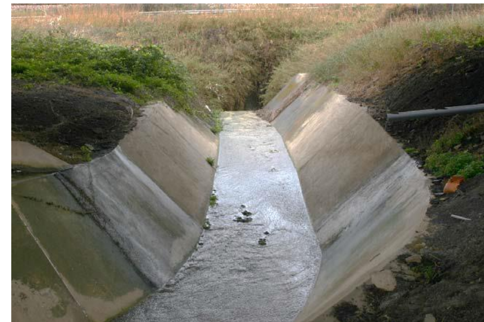
Figura 0-4. Fosso Cacchione e caditoia del tombino idraulico di sottopasso della ferrovia (vista verso mare)
