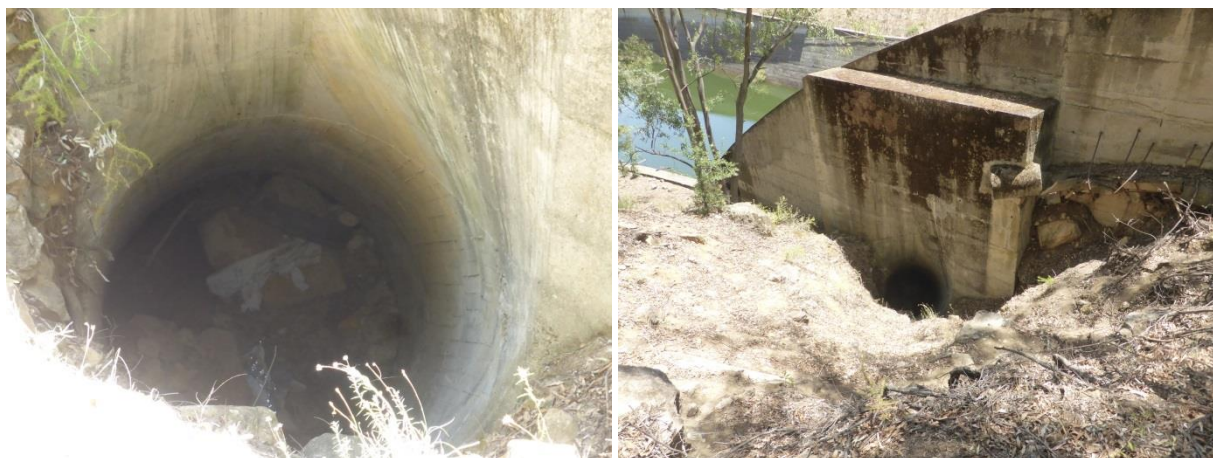
Figura 2-48. Deposito di sedimento all'interno della caditoia intasato dai sedimenti dell'area in dissesto
