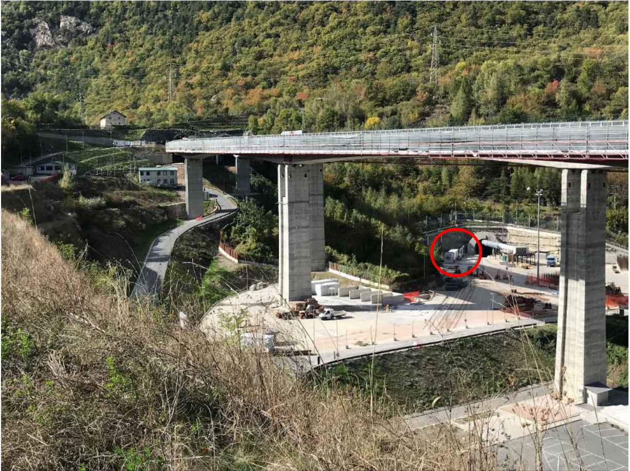
Figura 12. Vista generale dell'area di cantiere. Cerchiata in rosso è la zona su cui sorgerà lo Spazio Visitatori.
