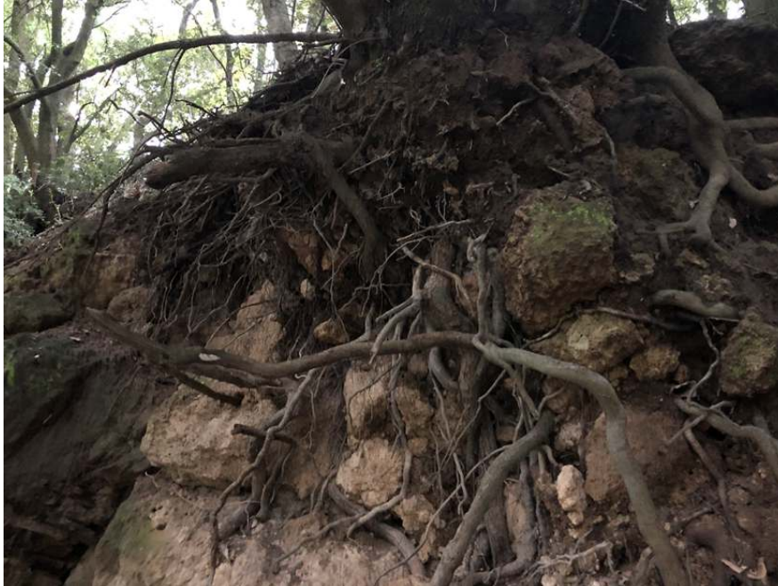
Figura 6: Sviluppo dell'apparato radicale all'interno dell'unità di Maddaloni. presente in testa e lungo la scarpata di monte. In evidenza lo sviluppo dell'apparato radicale che penetra lungo le fratture ed i vuoti presenti all'interno dei travertini.
