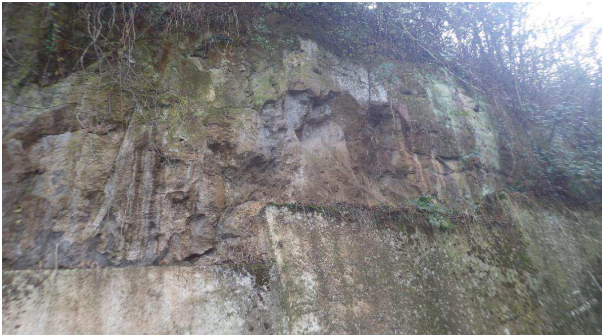
Foto 6 – Affioramento della litofacies litoide del Tufo Grigio Campano in località Breccelle, a NE della confluenza tra il Torrente Maltempo e il fiume Volturno.
