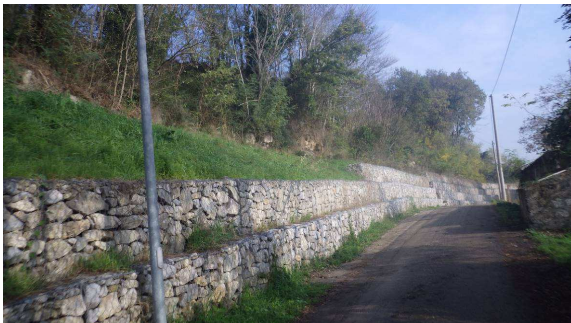
Figura 32 - Vista panoramica della scarpata morfologica nei travertini dell'Unità di Maddaloni, dove è possibile apprezzare i crolli in roccia che interessano i termini lapidei e gli interventi di consolidamento già realizzati al piede del versante.
