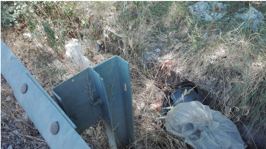
Cunetta (direzione BN) parzialmente coperta da vegetazione e totalmente ostruita da rifiuti
