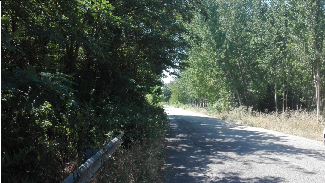
Barriera di sicurezza (direzione BN) parzialmente coperta da vegetazione
