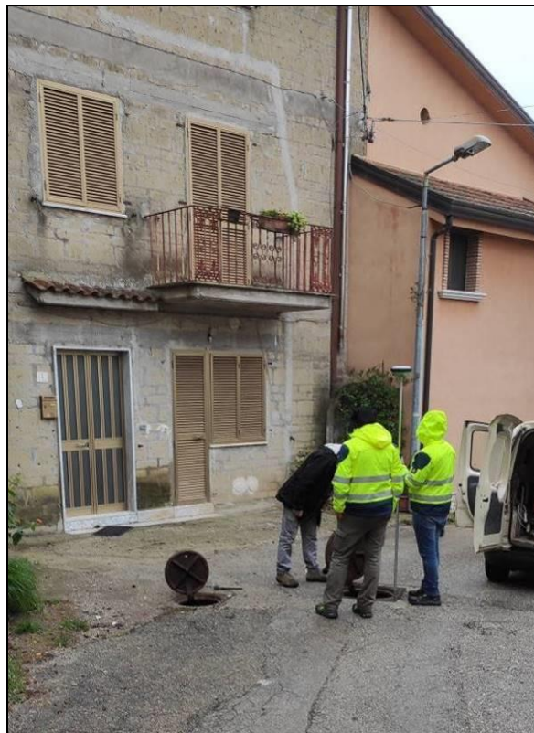
Tombino della Condotta Idrica in Complesso Abitativo
