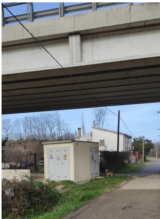
Cabina Enel/E-Distribuzione Trasformazione Elettrica (MT/BT)
