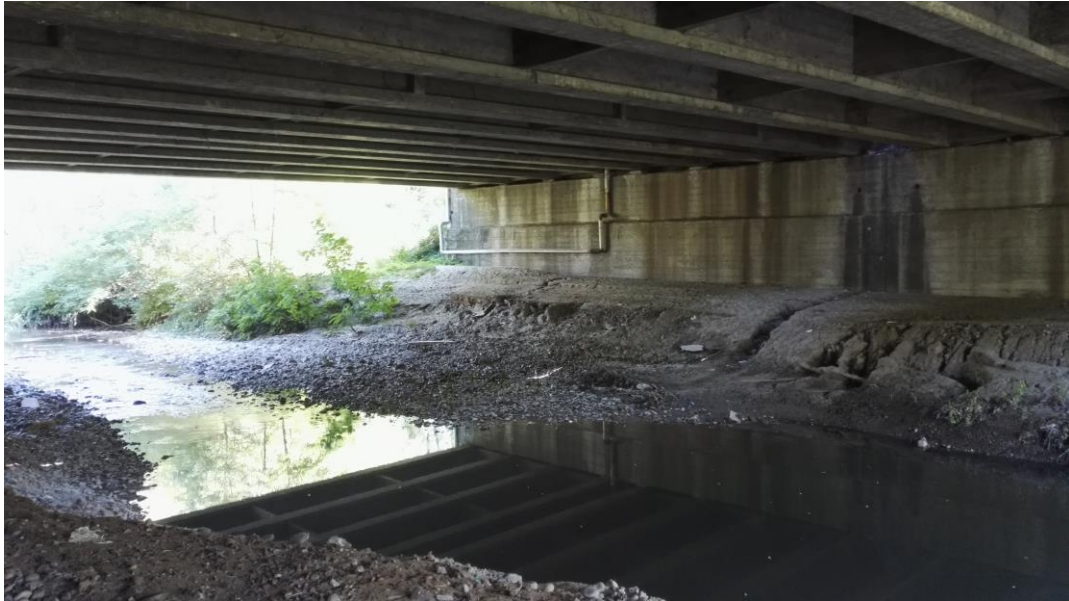
Figura 29 – Fenomeni erosivi al di sotto dell'impalcato sul Savena Vivo
