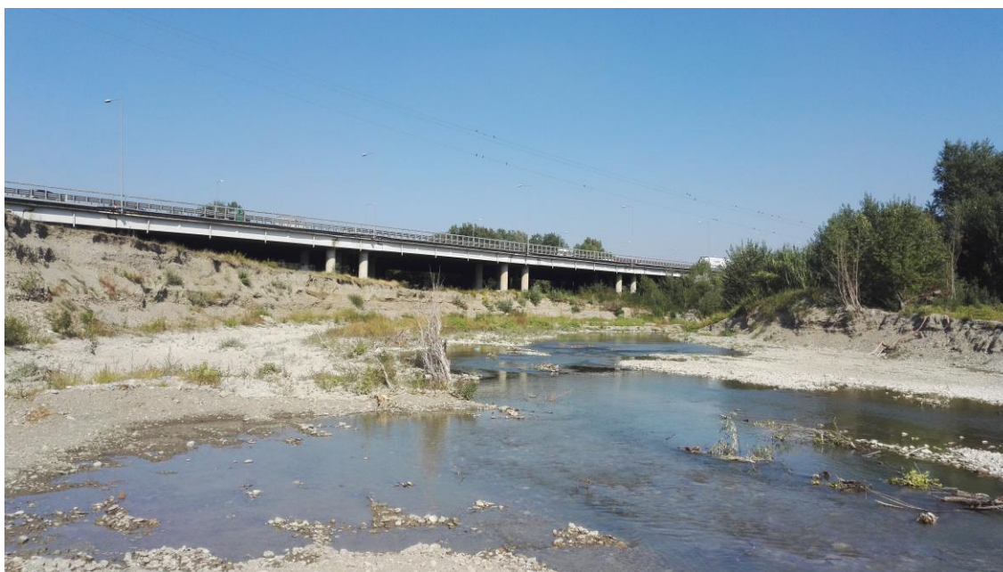
Figura 7 - erosione della golenia sinistra a monte del ponte.
