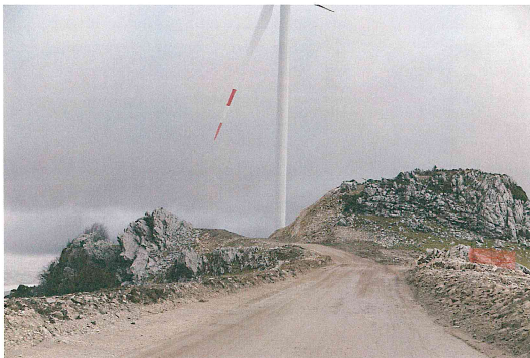
Foto 8 - Taglio della parte sommitale del rilievo calcareo di Ripa Maleportelle, effettuato per consentire il passaggio dei componenti degli aerogeneratori, con distruzione della vegetazione casmofitica ascrivibile all'habitat 8210.
