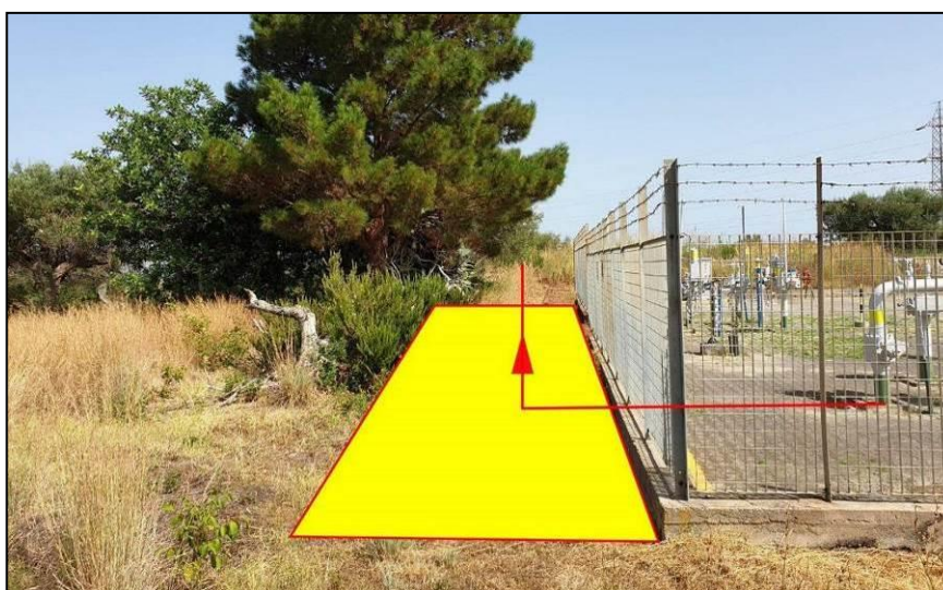
Foto 1/B – Impianto N. 6101001/10A sul Met. GA.ME.A DN 1200 (48") da ampliare
