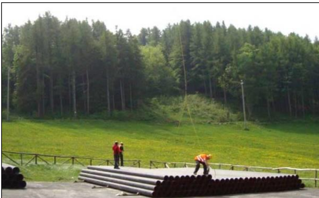
Fig. 1.2.1: Piazzola di accatastamento tubazioni
