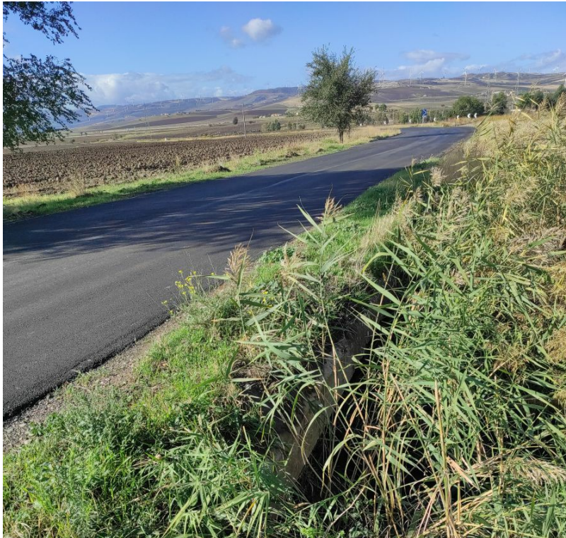
Foto p14: Vista della SP97 interessata dal passaggio del cavidotto in prossimità dell'attraversamento di un reticolo secondario
