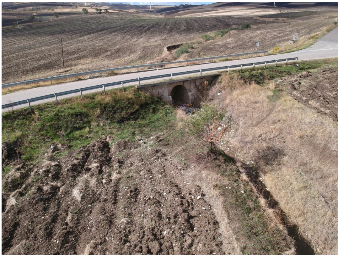
Foto P10: Vista della SP98 interessata dal passaggio del cavidotto in prossimità dell'attraversamento del corso d'acqua Fosso del Malo
