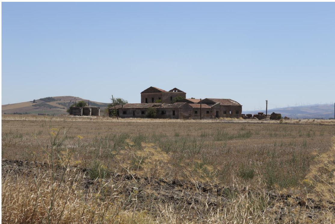
Figura – L'imponente complesso masserizio di Piano Morto all'interno dell'area indagine, in quasi totale abbandono e in avanzato stato di degrado (Foto Studio Rocco Carella).
