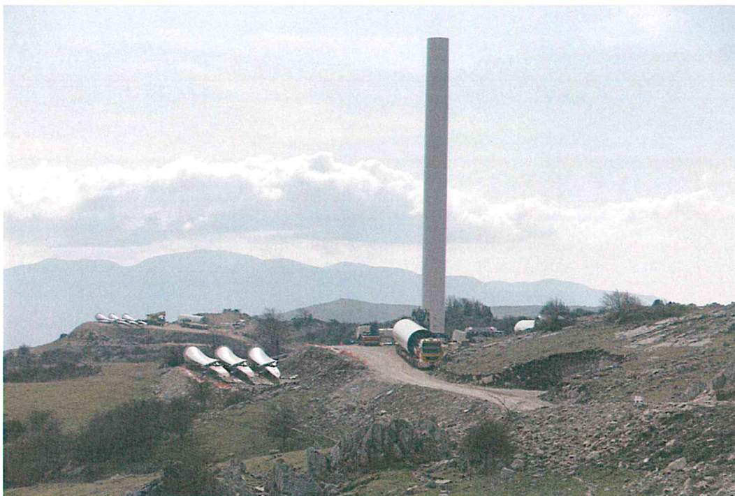
Foto 11 - Veduta panoramica dell'area fortemente alterata da strade, piazzole ed aree di manovra e stoccaggio (previsto ???), attorno ai pavimenti calcarei (habitat 8240*) delle foto 9 e 10 (visibili a destra nella foto)
