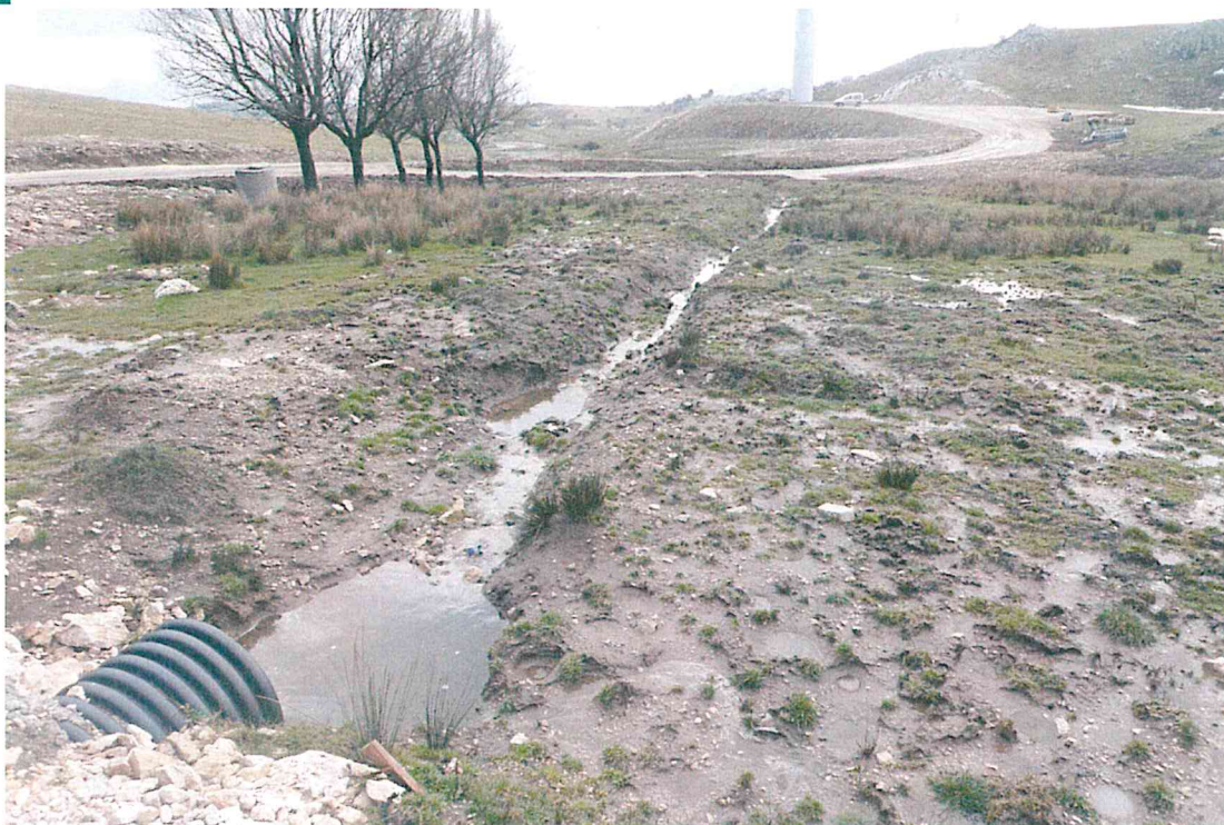
Foto 17 - Alterazione della circolazione superficiale delle acque con intubamenti e creazione di canaletti di scolo nell'area umida segnalata
