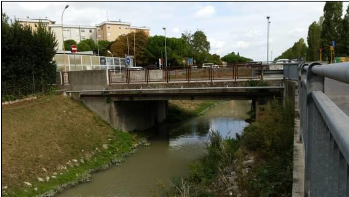
Foto n. 1.1/D – Canale principale in area urbana (Can. Lama) - attraversamento di metanodotto immersato al ponte -
