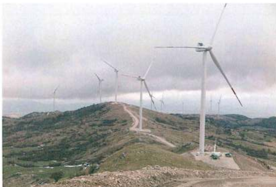
Foto 18 - Sbancamenti per piazzole e nuove strade nella zona sud orientale del parco e accumulo evidente di materiale ai bordi delle strade sull'habitat di Direttiva 6210 e, potenzialmente, 6210*
