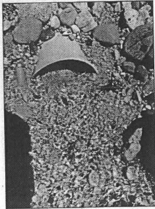
Foto 3-4-5: Tubo in pvc con fuoriuscita di acqua
