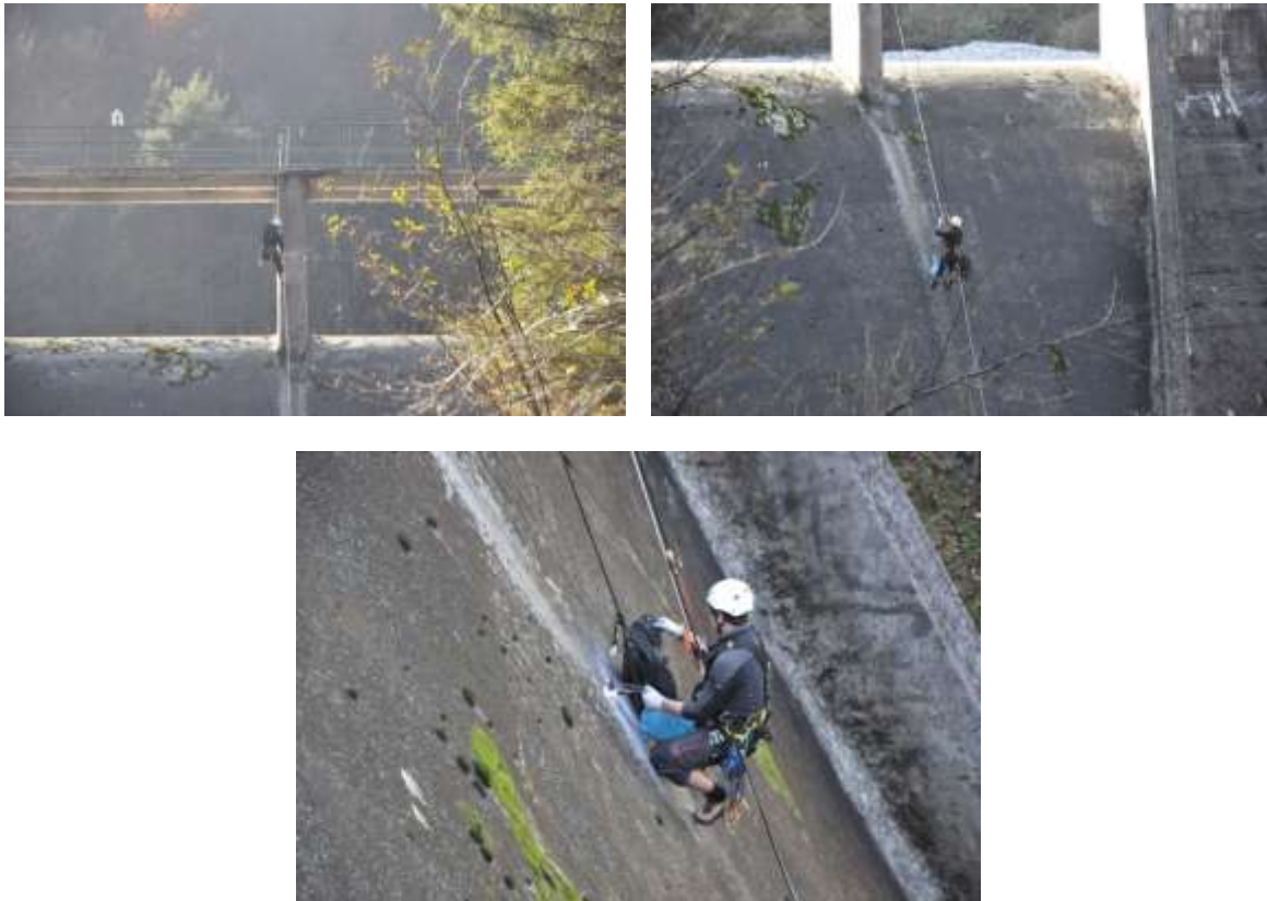
Operazioni di installazione degli accelerometri sul paramento di valle della Diga mediante operatore abilitato per lavori su funi
