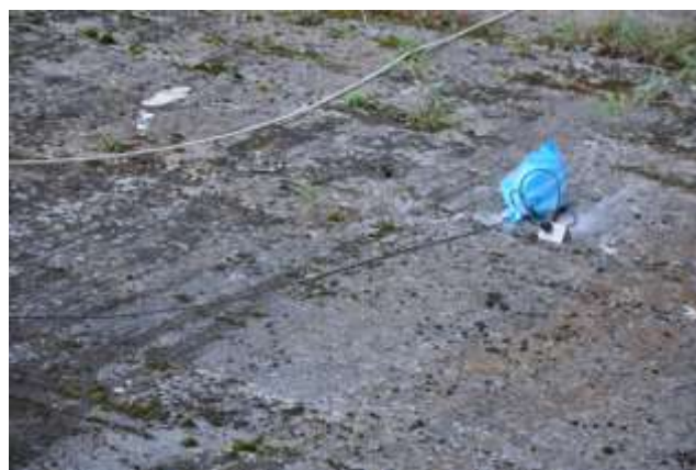
Sensori ubicati sul paramento di valle
