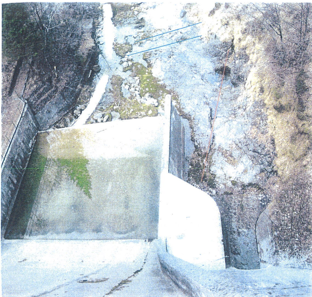
Foto 5: Diga di Cassiglio, sponda dx valle diga: discontinuità dei sistemi K1 (rosso) e K3 (azzurro).
