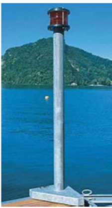
OPERE A MARE PONTILE DI ORMEGGIO IMPIANTO ELETTRICO - FANALE DI SEGNALAZIONE TESTA PONTILE
