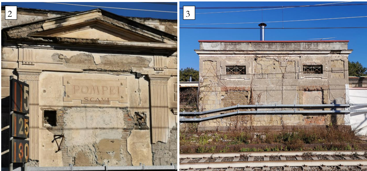
Figura 10: Stato di fatto fabbricati dell'antica Fermata Pompei Scavi – dettaglio del timpano del Fabbricato viaggiatori e del prospetto lato binari del locale bagni
