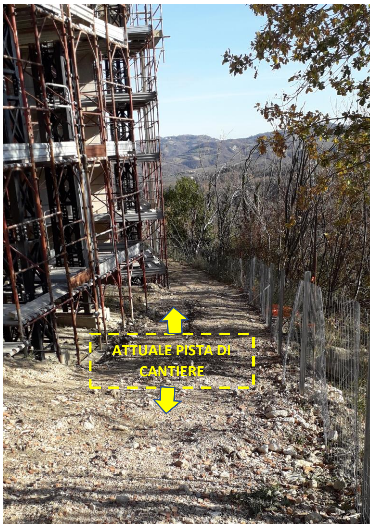
Figura 30 - Pista di cantiere attualmente già presente sul perimetro esterno del viadotto esistente
