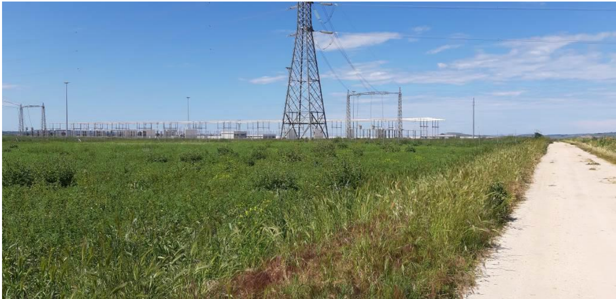
Figura 10 – Stazione RTN 380 kV “Rotello” di proprietà Terna
