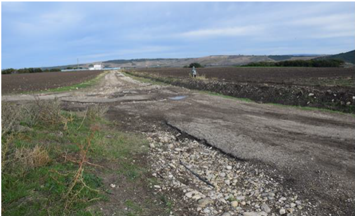
Figura 12 – Incrocio tra strada vicinale “San Paolo” e strada comunale “Difensa”. Come si scorge dalla fotografia, è evidente la necessità di adeguamento della viabilità esistente.
