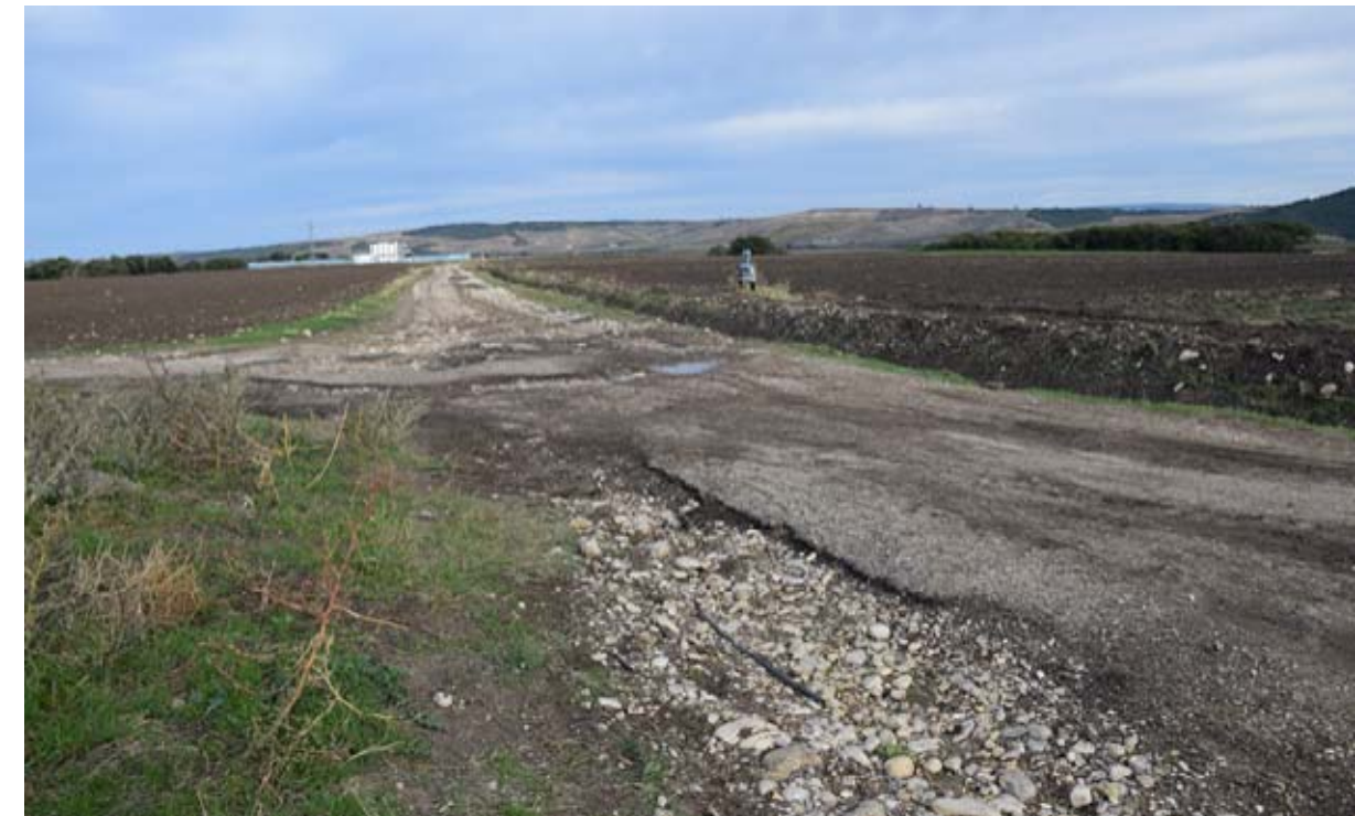
Figura 14 – Incrocio tra strada vicinale “San Paolo” e strada comunale “Difensa”. Come si scorge dalla fotografia, è evidente la necessità di adeguamento della viabilità esistente.
