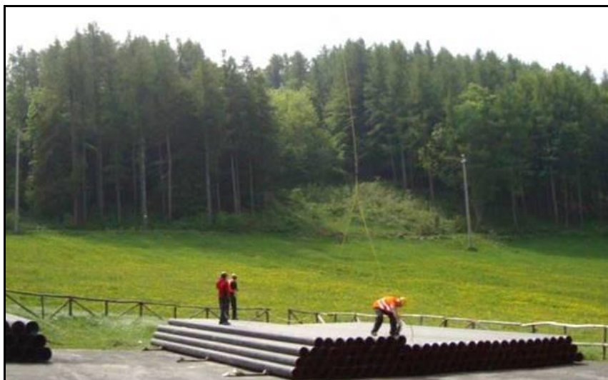
Fig. 4.4/A: Piazzola di accatastamento tubazioni
