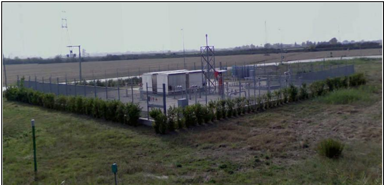
Foto n.11/A – Impianto con recente piantumazione di fascia di mascheramento.
