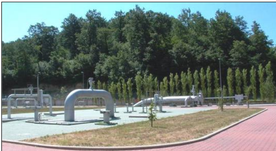
Fig. 8/B: Installazione tipo stazione di lancio e ricevimento PIG
