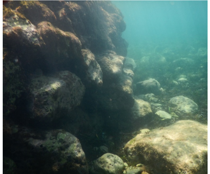
Figura 2.7: Fenomeni di erosione dello stato di imbasamento
