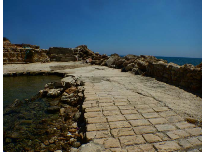
Fig. 2.4: Particolare della banchina esistente sul braccio di sopraflutto. Si osservi sia il cattivo stato del piano di banchina, che l'assenza di un muro paraonde e la disgregazione dell'opera foranea in massi naturali, a protezione del bacino esistente.
