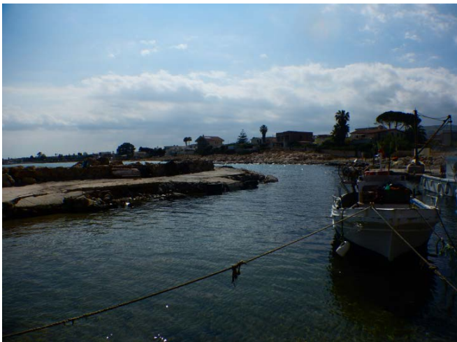
Fig. 2.5: Vista di insieme delle condizioni del braccio di sopraflutto, Si osservi il cedimento di un buon tratto del filo esterno della banchina posta sul braccio di sopraflutto.
