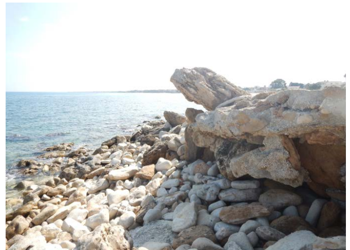
Fig. 2.6: Disgregazione dell'opera foranea a protezione del braccio di sopraflutto. Si osservi anche il ridotto volume dell'opera di protezione e la piccola pezzatura dei massi utilizzati che certamente ne hanno agevolato il processo di disgregazione.
