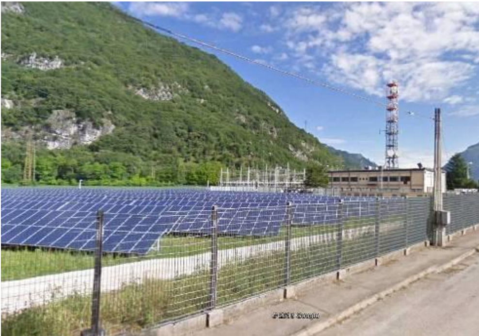
Figura 2-33. Stazione elettrica esistente.
