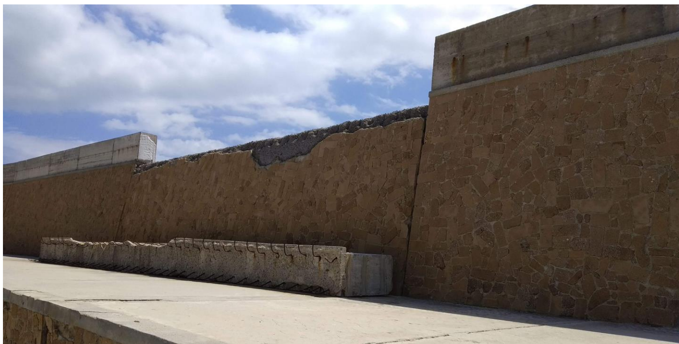
Foto 7 – Particolare crollo parziale del muro paraonde del molo sopraflutto
