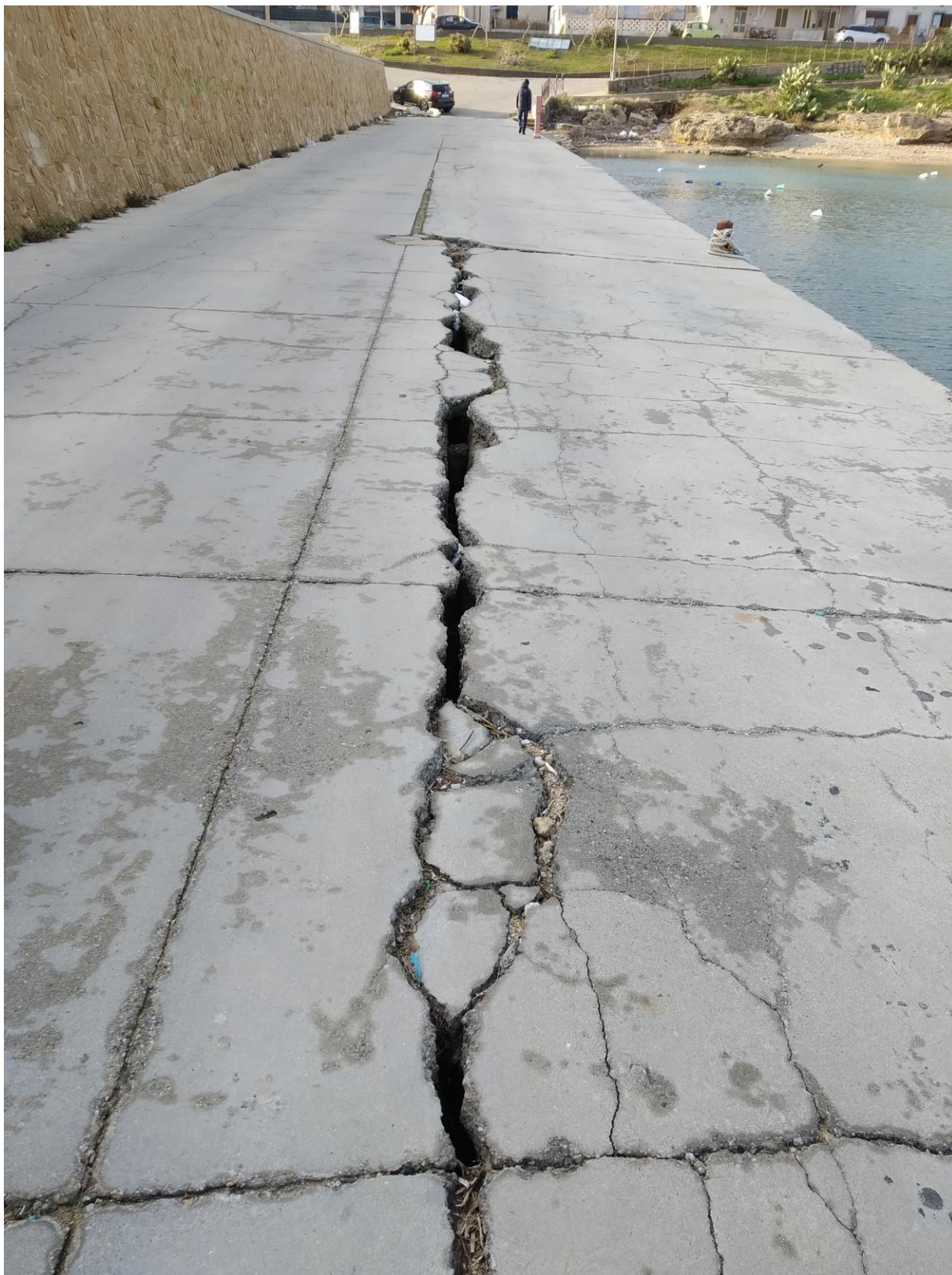
Foto 9 – Particolare cedimenti banchina del molo sopraflutto
