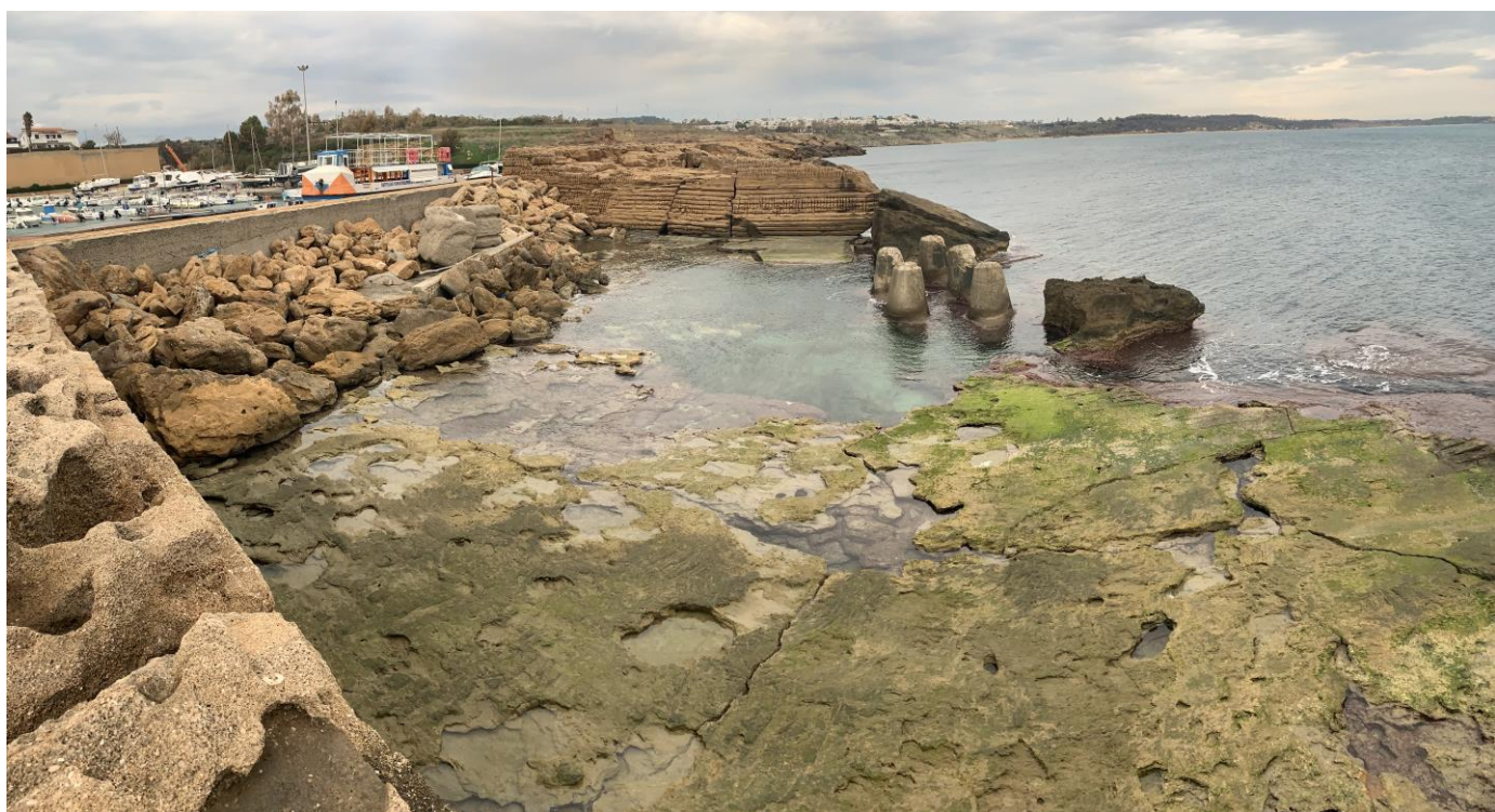
Foto 11 – Sbocco a mare degli scatolari presenti in corrispondenza della Banchina di Levante
