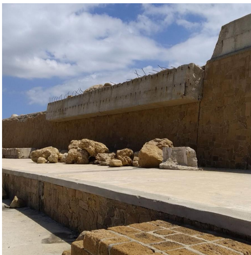
Foto 8 – Particolare ribaltamento parziale del muro paraonde del molo sopraflutto
