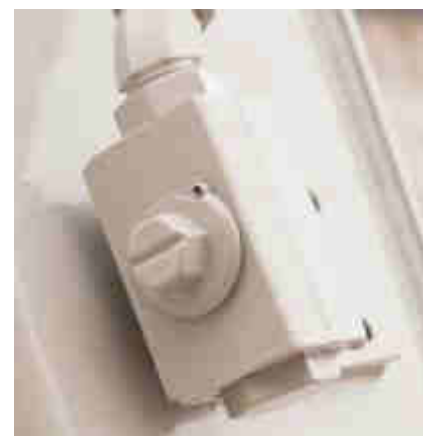
Rubinetti aperti/chiusi all'uscita dell'impianto ausiliario per evitare spillamenti e perdite di pressione in fase di installazione/ disinstallazione attrezzature.
