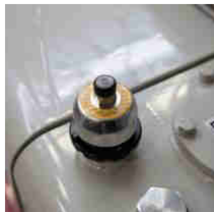
Sfiato aria serbatoio idraulico.
