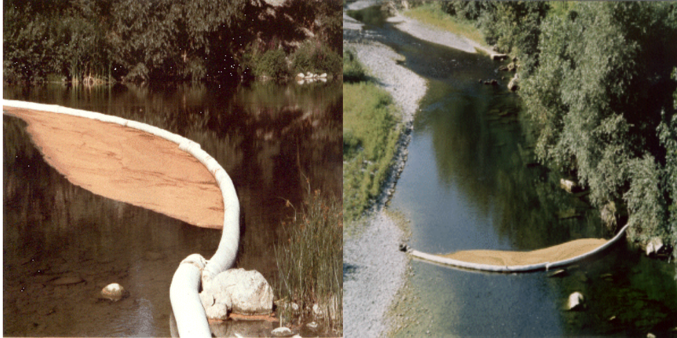
Esempi di barriere assorbenti galleggianti
