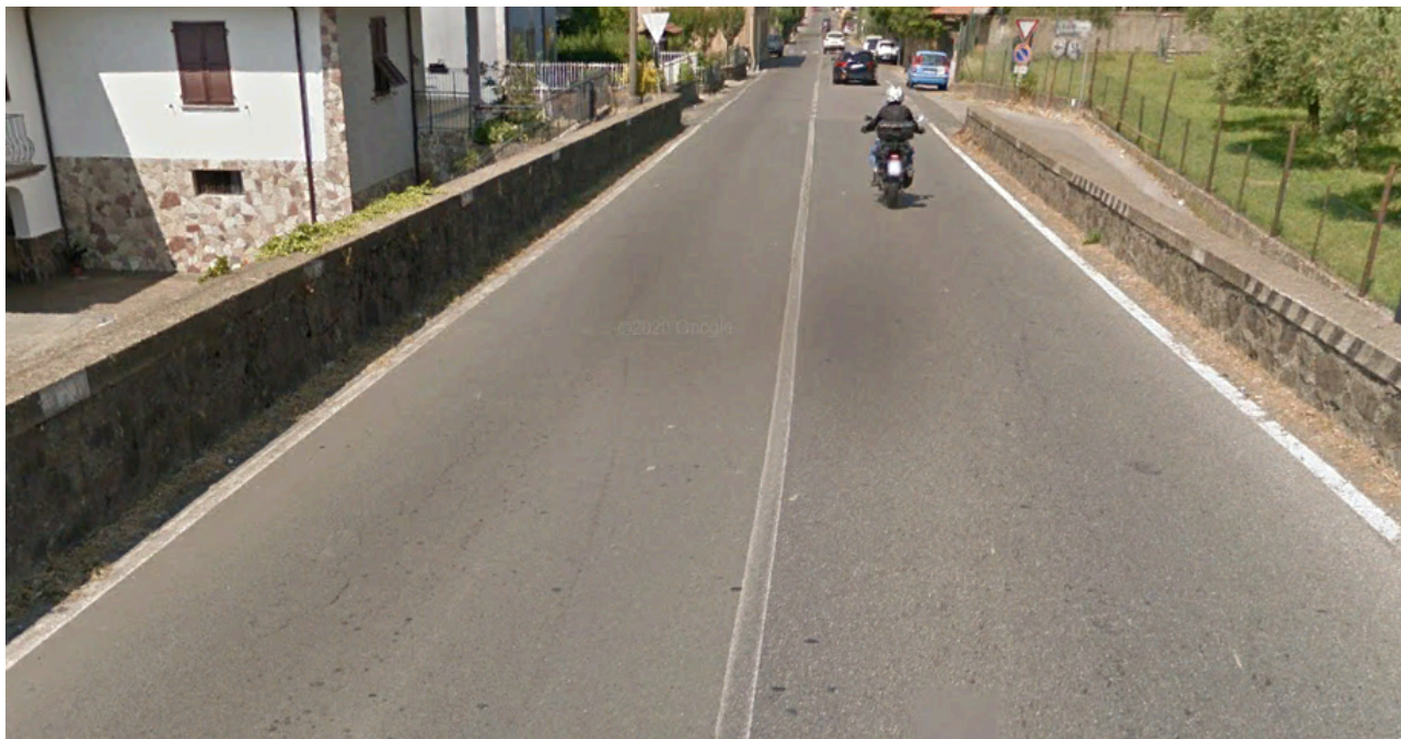
Rilevato di approccio al ponte crollato: punto di ripresa fotografica lato ponte
