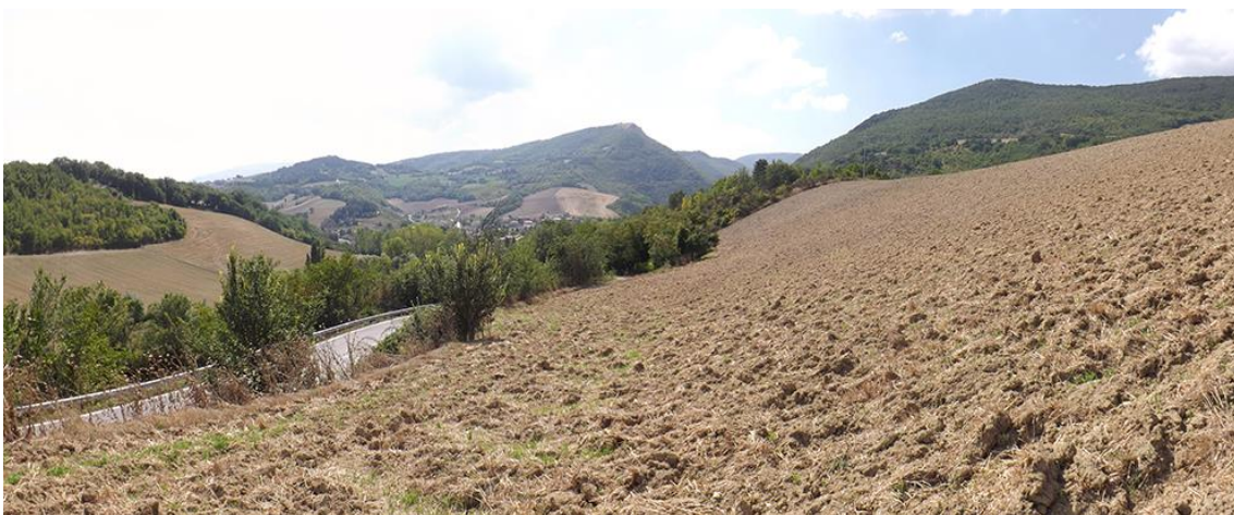
Particolare dell'area in frana a monte della strada provinciale
