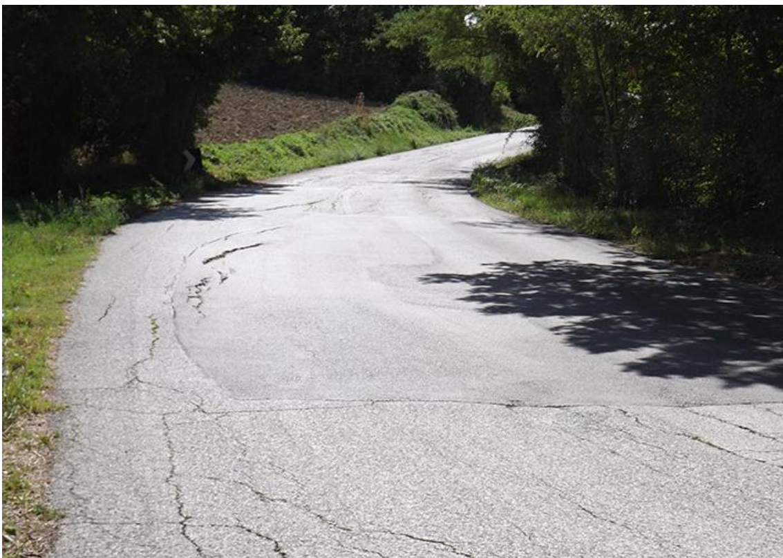
Particolare dei dissesti attivi in corrispondenza della strada comunale
