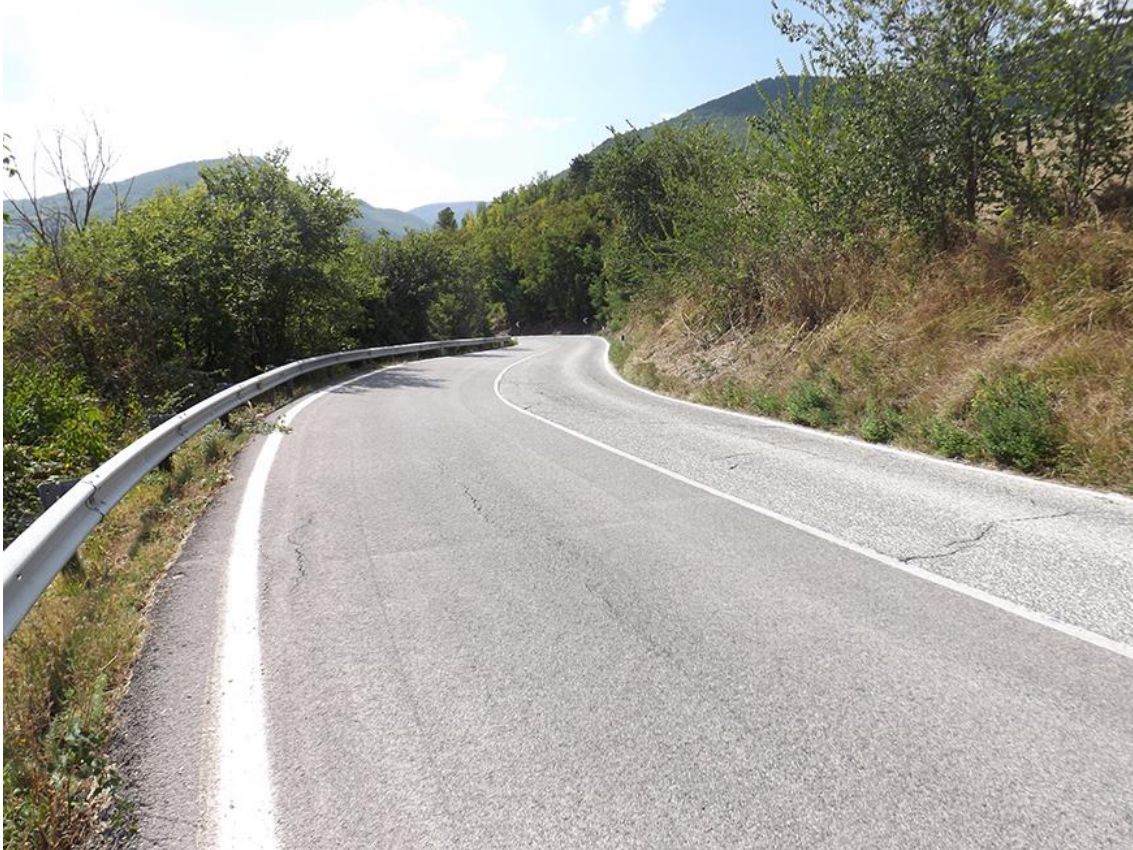
Particolare della strada provinciale coinvolta nel movimento franoso
