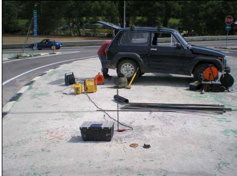
veduta d'insieme della stazione di misura
