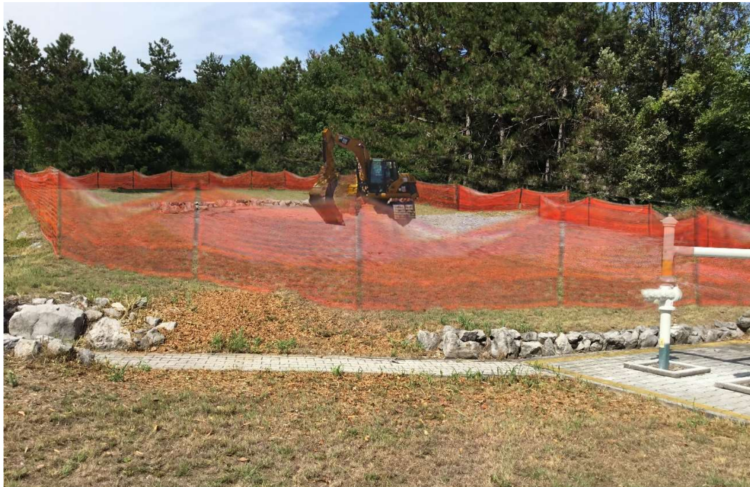
Figura 3-3 – Area cabina esistente n. 906/A in cui è previsto il PIDI n. 1 e area boscata limitrofa – Corso d'opera
